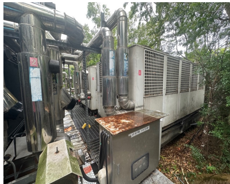
改善前設備照片
